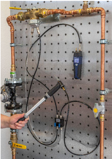
Fig. 13: Aansluitvoorbeeld met de Wöhler gasleidinglekttestset voor de belastingtest
