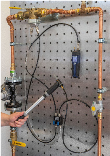
Fig. 24 Aansluitingen voor onderhoudsmeting
